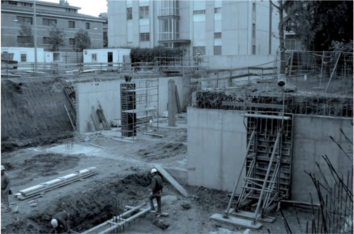
Inici de les obres del nou edifici del Museu de Ciències Naturals de Granollers, el maig de 2010. Fotografia: Museu de Ciències Naturals de Granollers.
